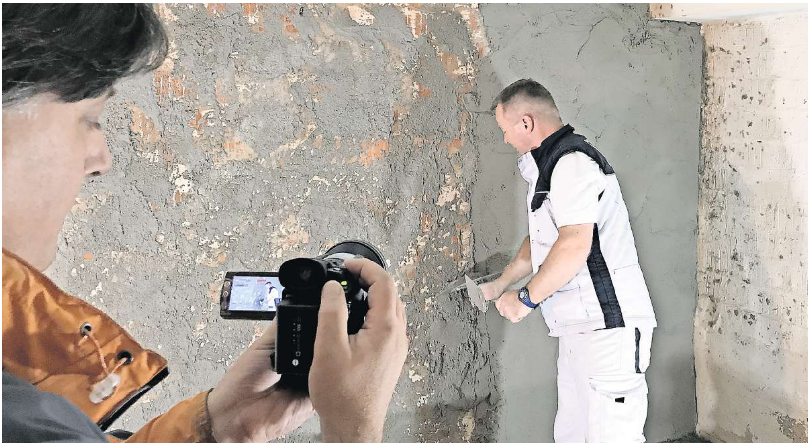
So geht es: Thomas Holstein zeigt und erklärt, wie der besondere Putz auf die Wände aufgetragen werden muss und wie er funktioniert. Mathias Bleckmann filmt den Vorgang für YouTube.
